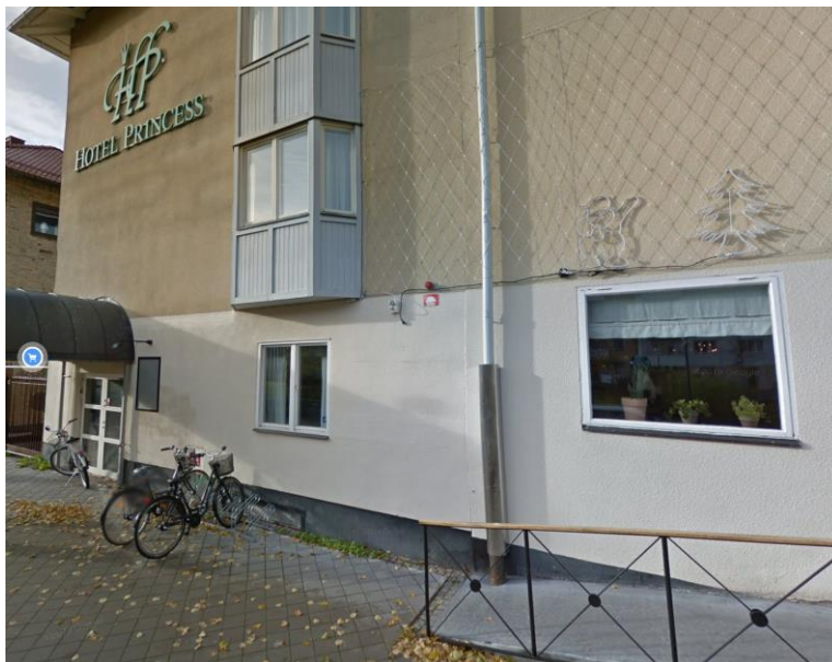
Figur 2-4. Slutet stuprör på fasad i öster. Källa: Google Maps.
