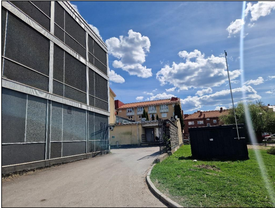
Foto över befintlig transformatorstation, mur och innergård på hotellets baksida ut mot Drottningtorget och Stadshuset.
