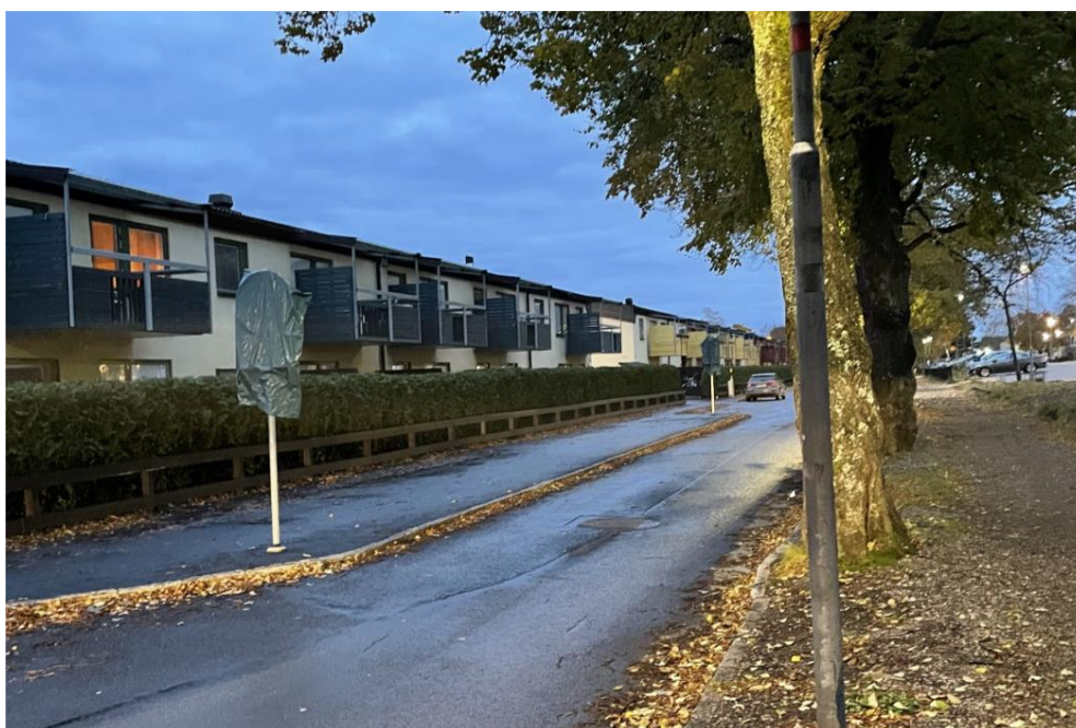
Den mittersta delen av Skolgatan som vanligtvis är reglerad med förbud för fordonstrafik med undantag för buss, vid tiden för fotot pågår vägarbete och regleringen gäller inte. Här stannar skolskjutsen.
